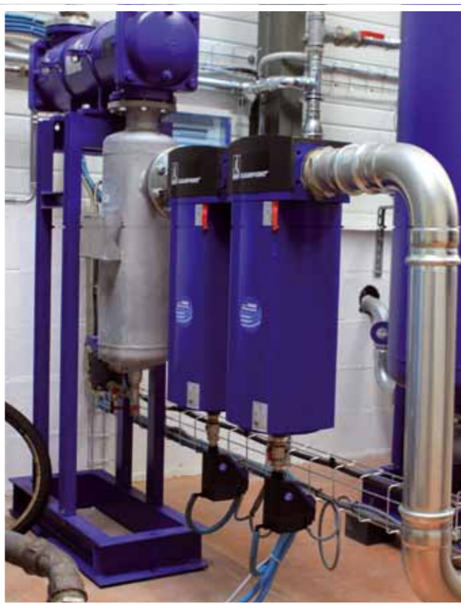
L'ensemble composé de l'échangeur air/eau, du séparateur centrifuge et de la filtration CLEARPOINT® ont permis d'abaisser la température de l'air comprimé de manière efficace tout en éliminant les particules solides, les poussières et l'huile contenus dans l'air comprimé.
